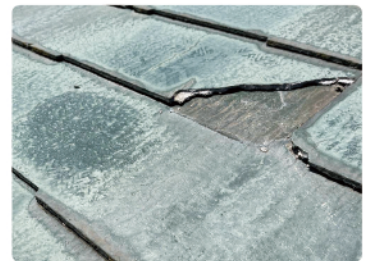
屋根材の割れ
