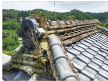
屋根本体の経年劣化
