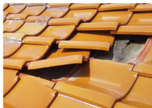
屋根材のズレや浮き
