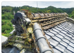
屋根本体の経年劣化
