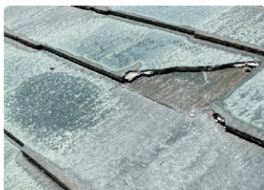
屋根材の割れ
