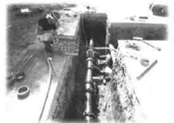
地面を通っている水道管です。
